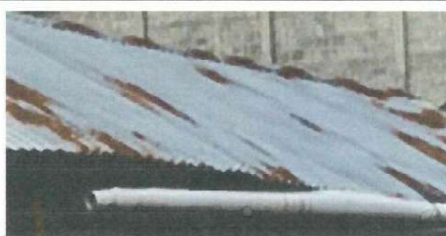
Foto 2: Se observa que la cubierta del techo requiere remozamiento, ya que se encuentra en mal estado debido al desgaste y deterioro con el paso del tiempo.
