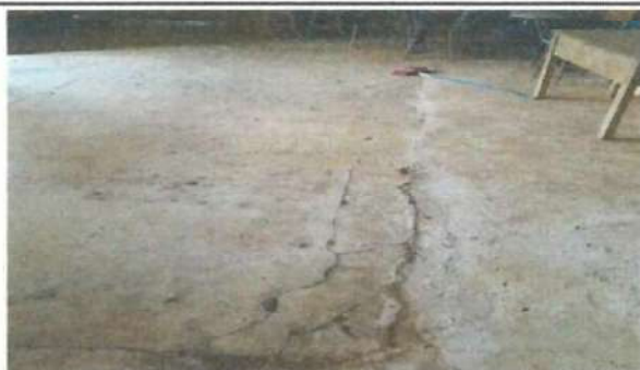
Foto 3: Se observa que la torta de concreto se encuentra en mal estado, presentando grietas, desgaste y posibles desprendimientos.
