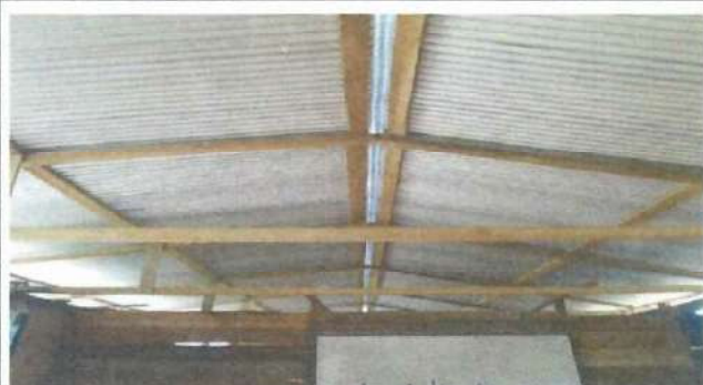
Foto 1: Se observa el mal estado de la estructura de techo debido al desgaste natural de la madera, lo que pone en riesgo la estabilidad del mismo.
