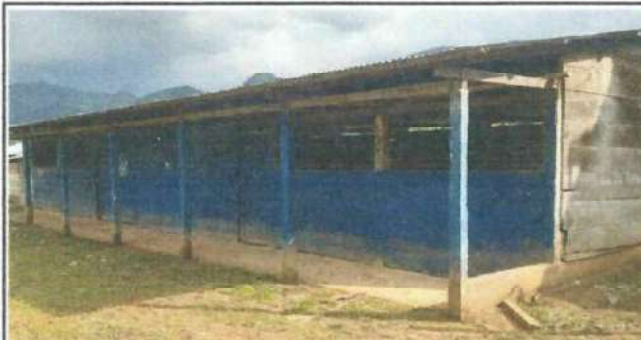
Foto 4: Se observa que las paredes del centro educativo se encuentran en mal estado, presentando grietas, desgaste y desprendimiento de material. Este deterioro afecta la apariencia del establecimiento.
